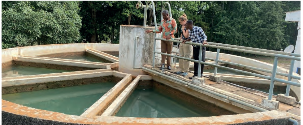
Sedimentationstank des Wasserwerks in Techiman (Ghana) zur Aufbereitung des Flusswassers für die die Trinkwasserversorgung
